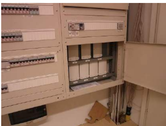
Bild 20. Elskåp i klassrum med regulatorer till radiatorer.
