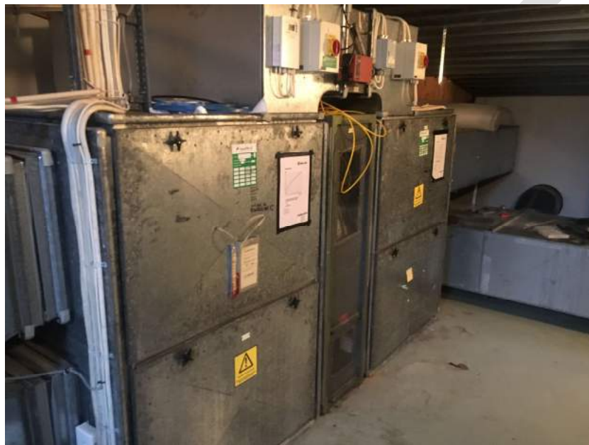
Bild 10: Befintlig luftbehandlingsaggregat (LA5). Placerat i fläktutrymme på tak.
