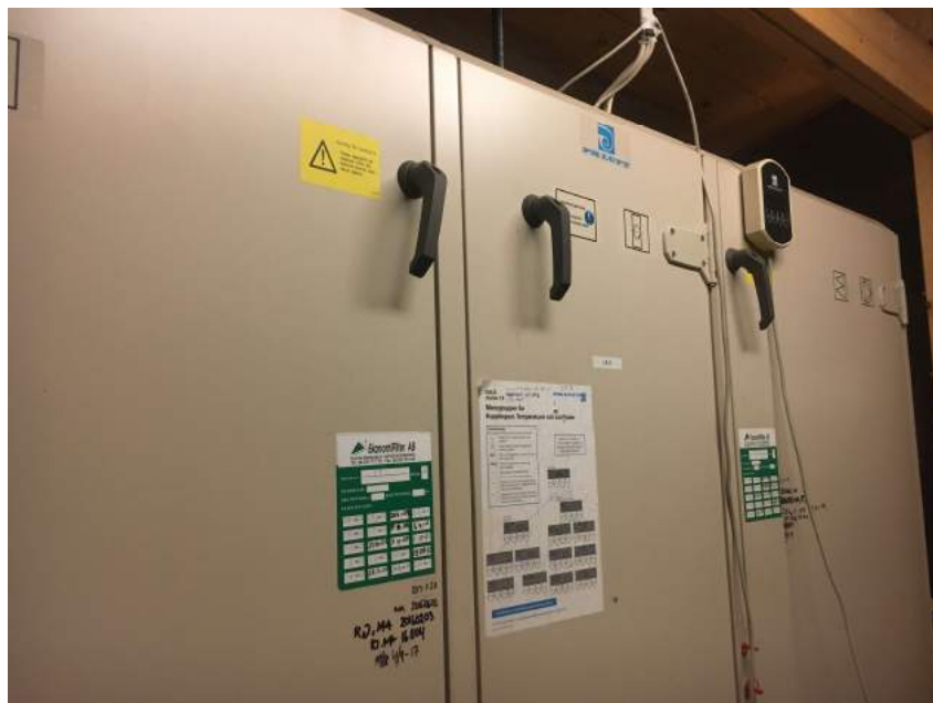
Bild 8: Befintligt luftbehandlingsaggregat (LA3). Placerat på vind.
