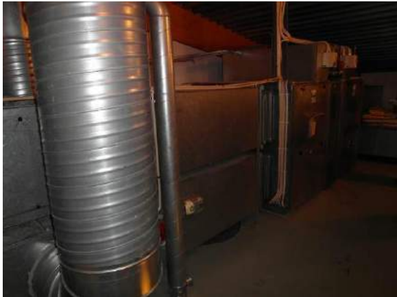
Bild 16. FTX-aggregat på vind, svårtillgängligt.
