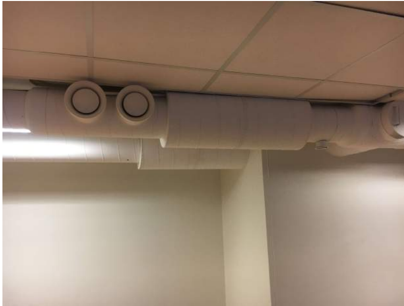
Bild 11: Ventilationskanaler förlagda i tak i äldre byggnadsdelar.
