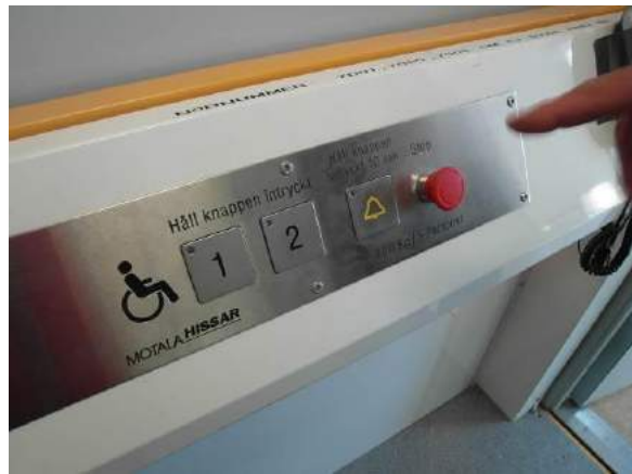
Bild 19. Panel i plattformshiss.
