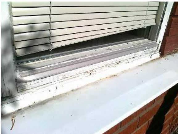
Bild 3. Fönster med träkarmar, målningsbehov
