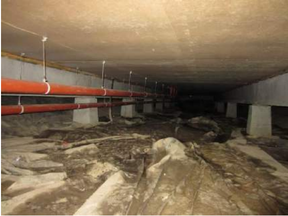
Bild 11. Krypgrund under nyare delen med omfattande fuktproblem.
